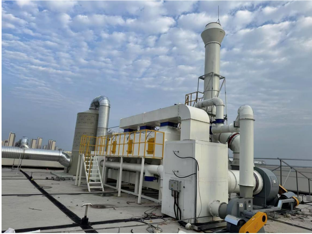
图 3-4 废气处理设备现状图
